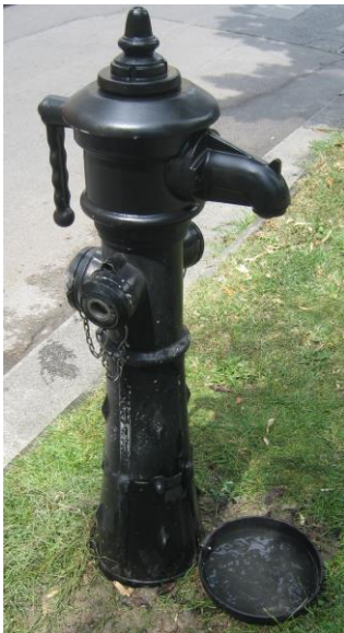
Altstadtrinkhydrant mit Auffangschale
