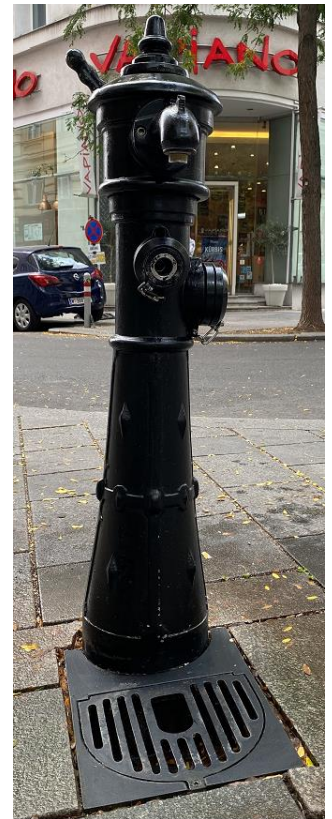
Altstadtrinkhydrant mit Ablaufbecken mit Gitter
