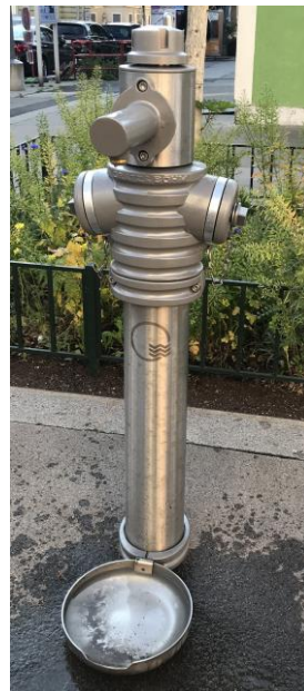
Edelstahltrinkhydrant mit Auffangschale
